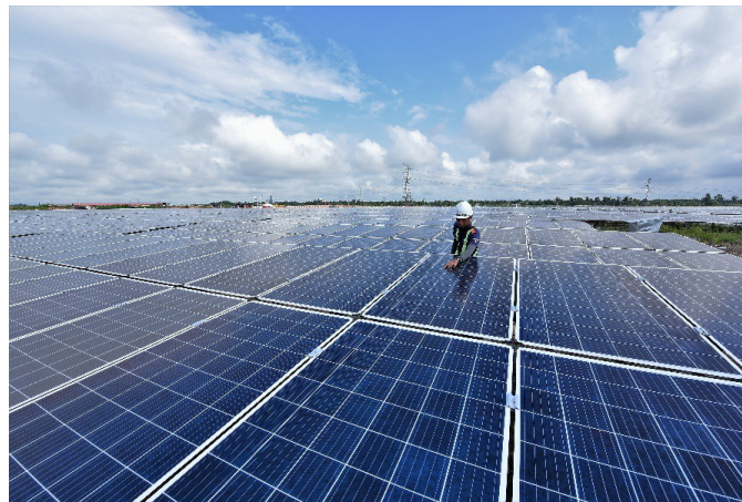
Above: TRe’s solar panels
